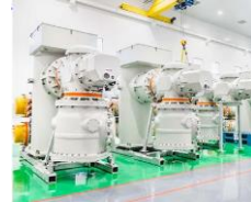
پست‌های عایق گازی (GIS)
